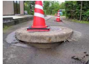
浮上したマンホール（中越地震）
