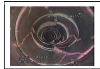
劣化した管きょ
